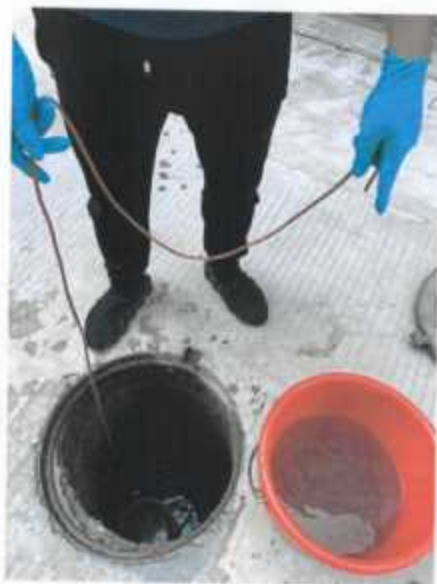
生活污水排放口
