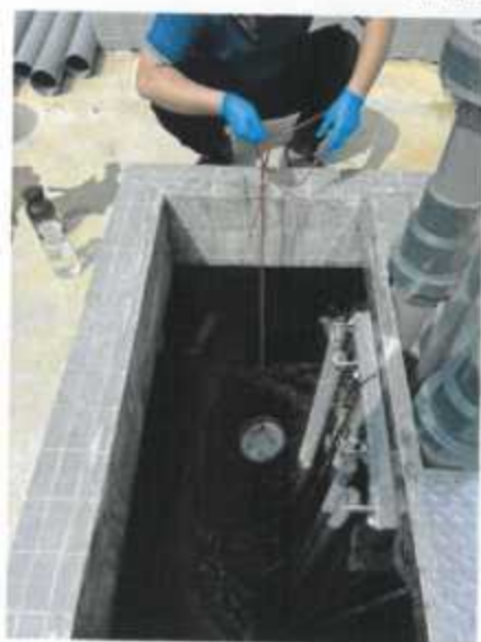
生产废水处理前采样口
