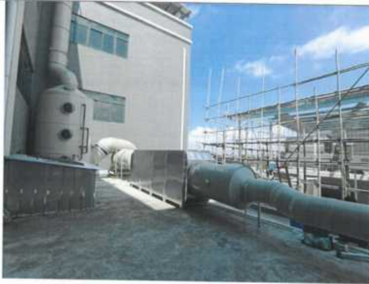
图 3-5 废水处理过程废气治理设施图
